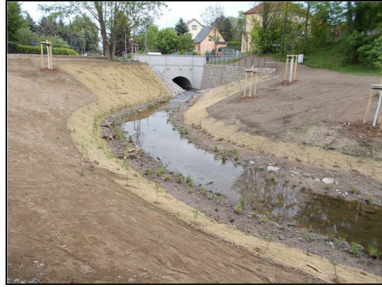
Abb. 8: nach der Maßnahme: Offengelegter Gewässerabschnitt mit Anschluss an noch bestehende Verrohrungsstrecke, Blick stromab, 10.05.2019
